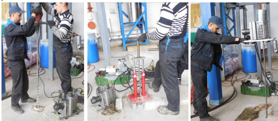
Рис. 2 – Проходка скважины внутри котельной СОО «Конте Спа» через высверленное отверстие в бетонном полу (а), извлечение штанг бура или зонда из скважины (б) и динамическое зондирование ґрунта в скважине (в)
