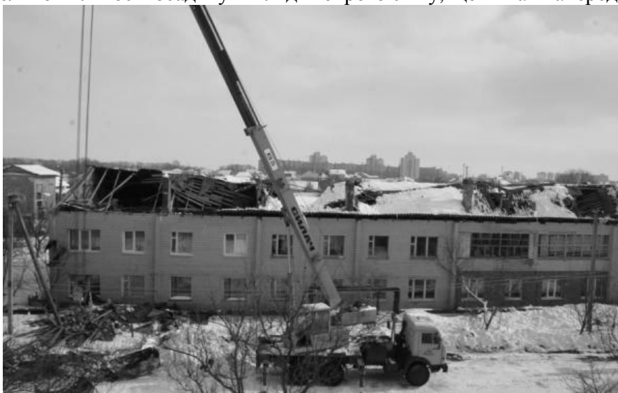
Рис. 2. Обрушення даху багатоквартирного житлового будинку, м. Чернігів
