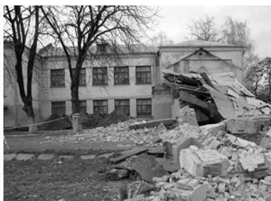
Рис. 5. Часткове обрушення будівлі колегіуму № 11, м. Чернігів
